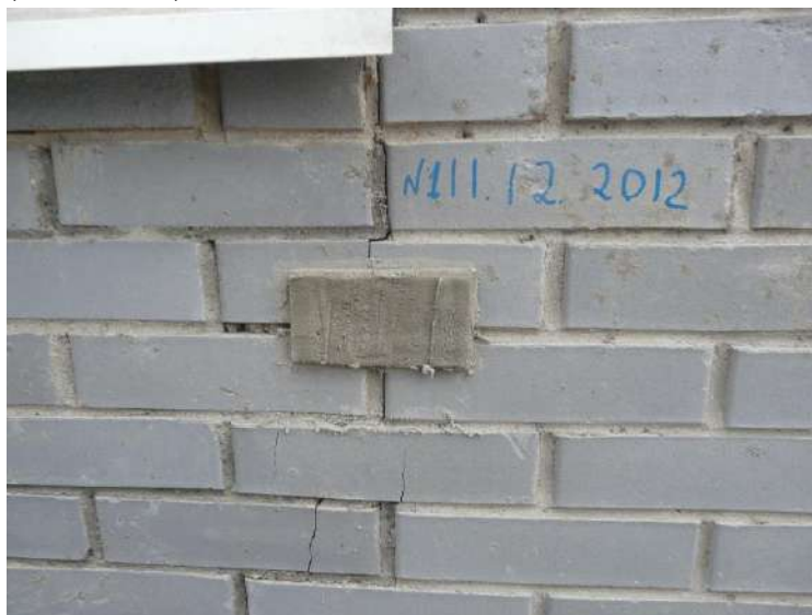
Рис. 12 Пример установки маяков из цементно-песчаного раствора для контроля трещин в кирпичной кладке.
